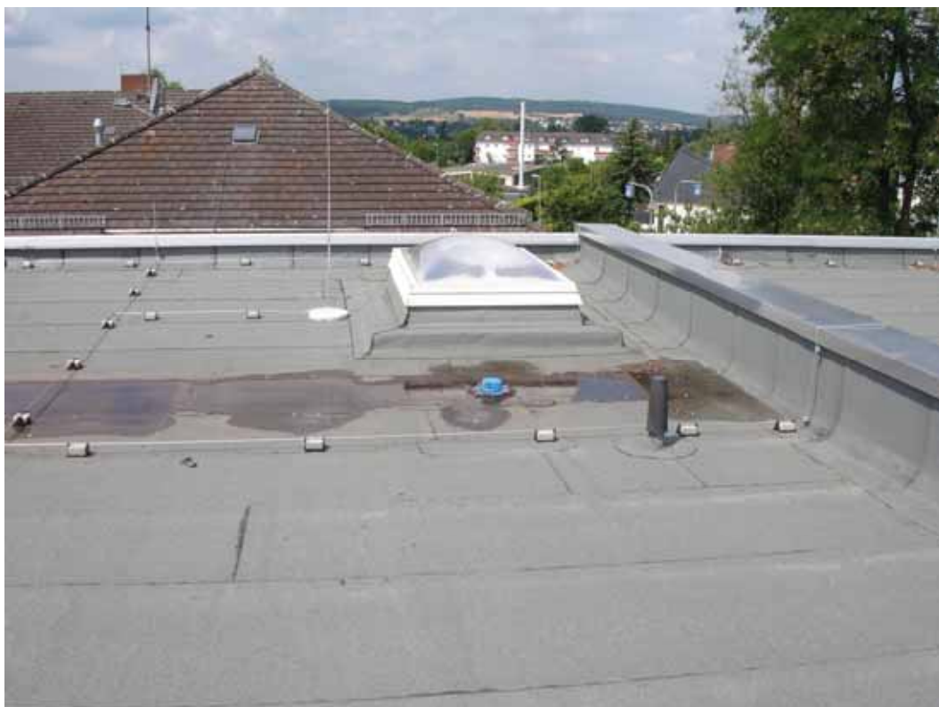
Abbildung 31-1: Flachdach ohne Oberflächenschutz und Längsgefälle
