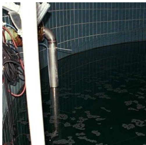
Ansicht 40: Gemeinde Friedewald - Wasserkammer / Trinkwasserspeicher - Aufnahme vom 11. Juni 2002
