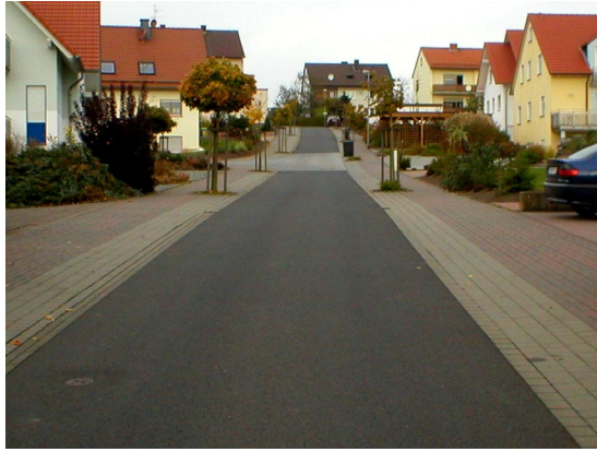
Ansicht 117: Beispiel für eine Straße der Zustandsklasse 1. Fliesen. Aufnahme aus dem Jahr 2002.
