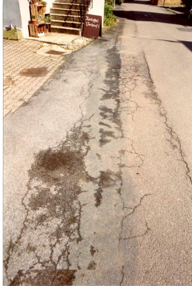
Ansicht 106: Schadensbildung bei der Patch-Methode. Stadt Waldeck. Aufnahme aus dem Jahr 2002.
