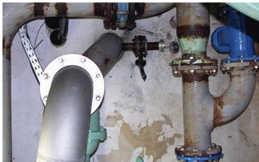
Ansicht 45: Wasserverband Georg Joseph, Runkel: Pumpen im Wasserwerk / Rohrkeller - Aufnahme vom 25. Juni 2002
