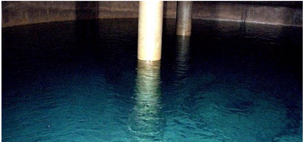
Ansicht 51: Stadt Wetter - Trinkwasserspeicher / Hochbehälter - Aufnahme vom 21. Mai 2002 Neuwertiger Hochbehälter mit angemessener hygienischer Speicherung des Trinkwassers.
