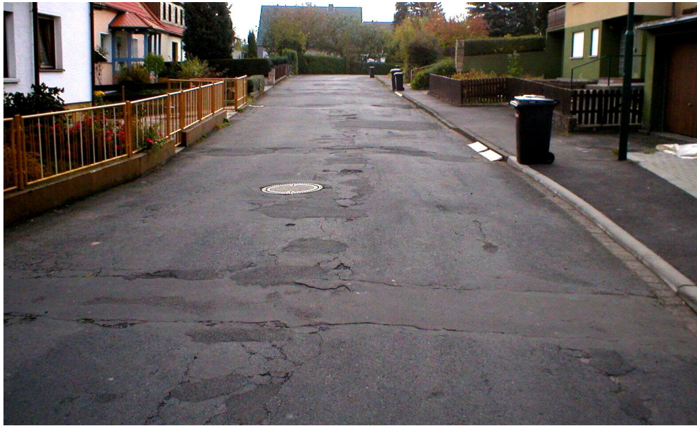
Ansicht 94: Beispiel für eine Straße der Zustandsklasse 5. Flieden. Aufnahme aus dem Jahr 2002.
