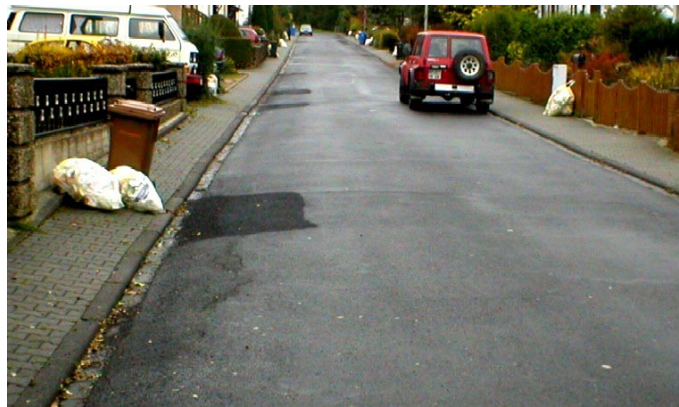
Ansicht 97: Beispiel für eine Straße der Zustandsklasse 3. Heidenrod. Aufnahme aus dem Jahr 2002.
