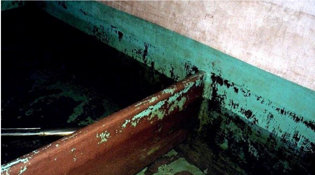
Ansicht 41: Aufbereitungsanlage Weichersbach / Gemeinde Sinntal - Aufnahme vom 22. Juli 2002
