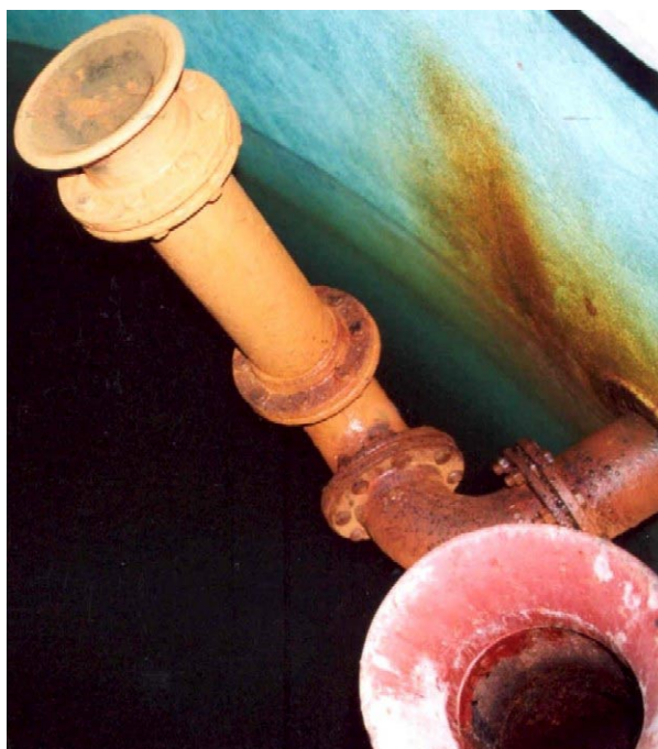
Ansicht 44: Hochbehälter Jakobsberg / Wasserbeschaffungsverband Ostteil - Aufnahme vom 4. Juni 2002
