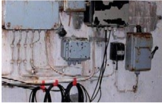
Ansicht 47: Gemeinde Ehringshausen: Elektrische Anlage zum Tiefbrunnen Katzenfurt - Aufnahme vom 12. September 2001
