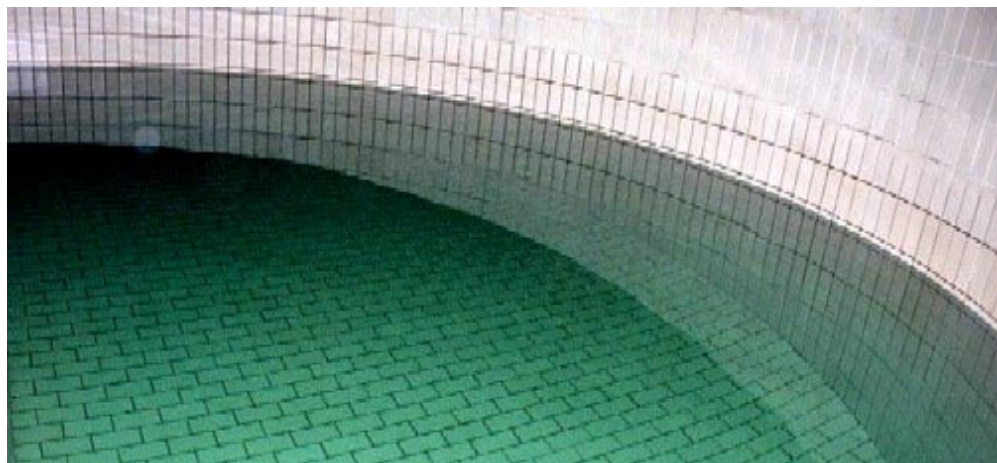
Ansicht 43: Gemeinde Sinntal - Trinkwasserspeicher / Hochbehälter - Aufnahme vom 22. Juli 2002
