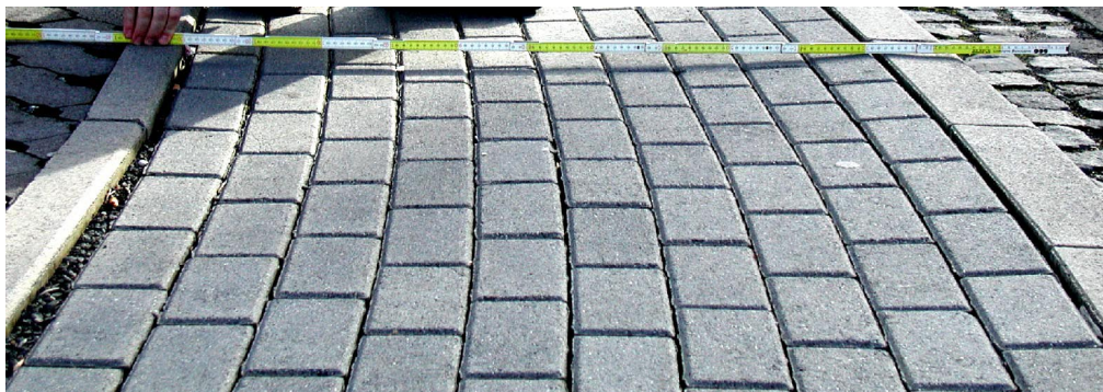
Ansicht 103: Ausbildung von Unebenheiten (Absackungen) und Ausbildung einer offenen Fuge an der Bordsteinkante. Gemeinde Mücke. Aufnahme aus dem Jahr 2002.
