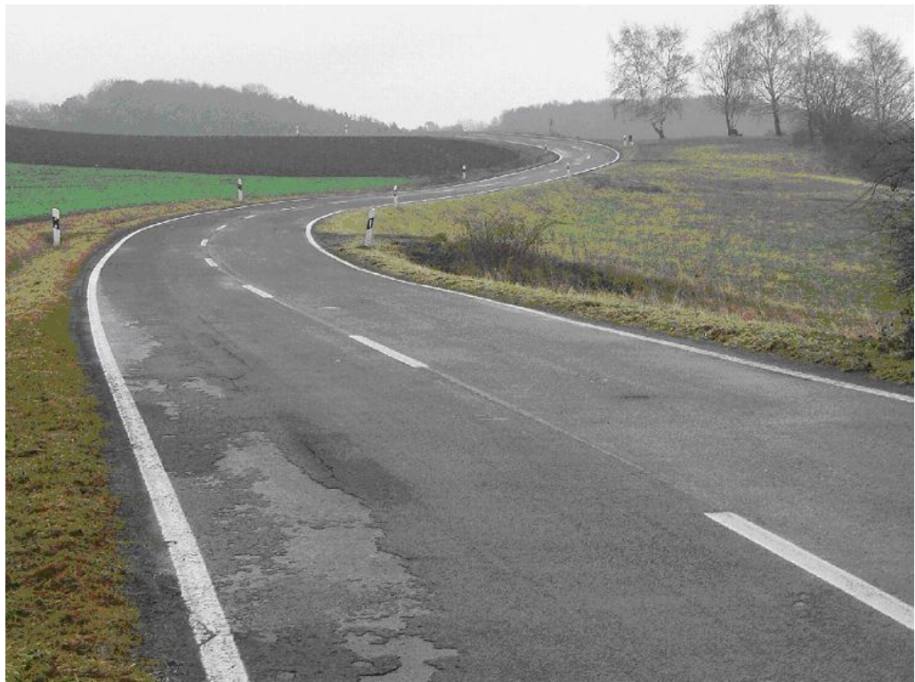
Ansicht 141: Straße mit ablösenden Dünnschichtbelägen. Zustandsklasse 3,50 bis 4,49 (kritisch). Werra-Meißner-Kreis. K 40, Wolfterode – Frankershausen. Aufnahme aus dem Jahr 2004.
