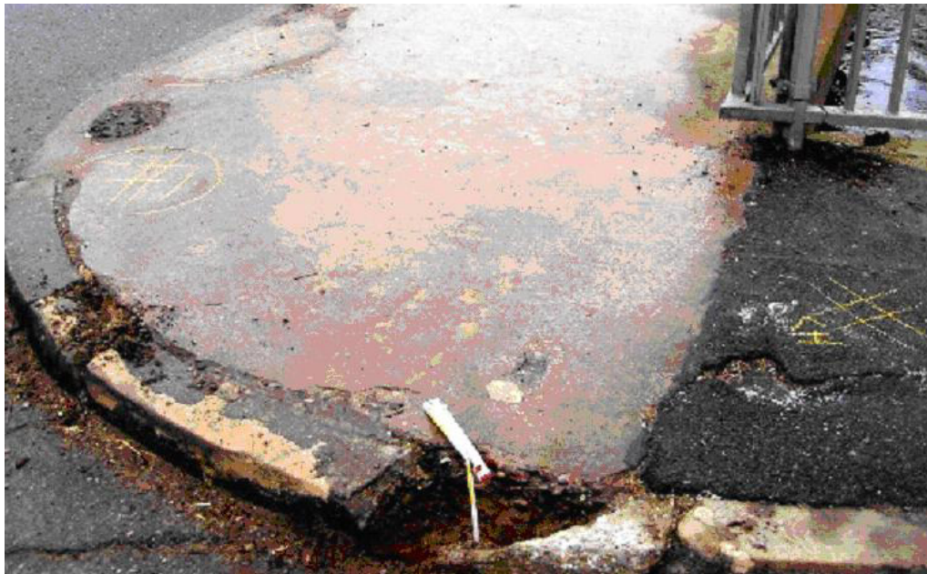
Ansicht 152: Brückenbauwerk mit kritischem Bauwerkszustand und Zustandsnote 3,2. Odenwaldkreis. Unterführung Mümling (Brückennummer 6219 534) im Zuge der K 85. Aufnahme aus dem Jahr 2005.
