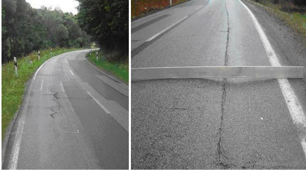
Ansicht 137: Straße der Zustandsklasse 4,50 bis 5,00 (überfällig). Odenwaldkreis. K 112, Ober-Naues - Anschluss L 3106. Aufnahmen aus dem Jahr 2005.
