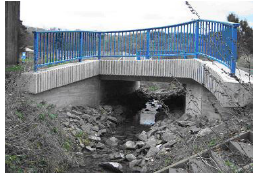
Zustandsnote 1,9 (0/ 0/ 2) Unterführung Hainsbach, Brücken-Nr. 4725 630 im Zuge K 59, Werra-Meißner-Kreis
