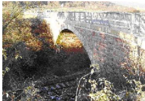
Zustandsnote 4,0 (3/ 3/ 3) Unterführung Kreisbahn Brücken-Nr. 5125 551 im Zuge K 15 Landkreis Hersfeld-Rotenburg
