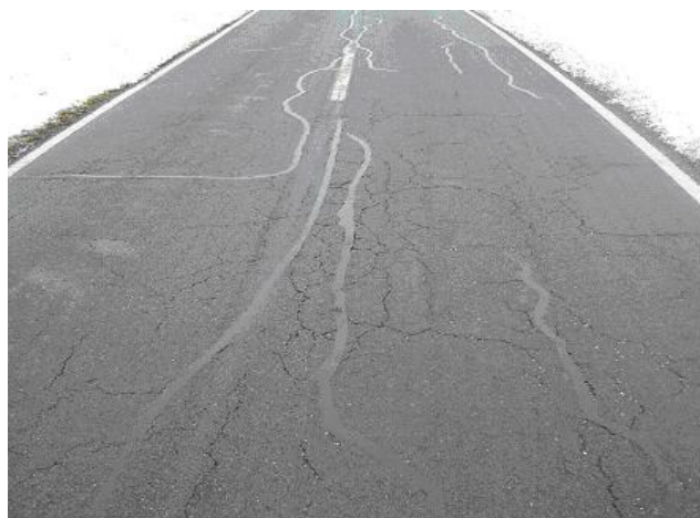
Ansicht 136: Straße mit gerissenem Dünnschichtbelag. Zustandsklasse 3,50 bis 4,49 (kritisch). Hochtaunuskreis. K 759, Hundstadt – Anschluss B 456. Aufnahme aus dem Jahr 2005.
