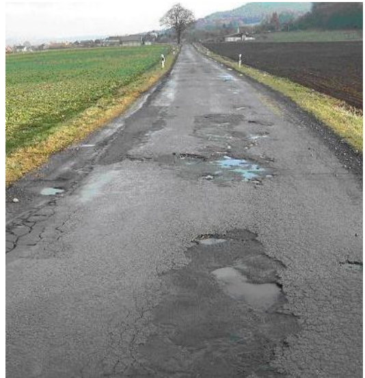
Ansicht 145: Straße mit Ausbrüchen, Rissen, Flickstellen und zerstörten Banketten. Zustandsklasse 4,50 bis 5,00 (überfällig). Landkreis Waldeck-Frankenberg. K 58, Korbach-Lengefeld – Korbach - Lelbach). Aufnahme aus dem Jahr 2004.
