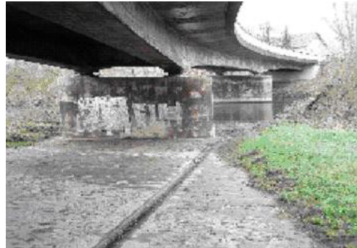
Zustandsnote 2,7(1/ 3/ 2) Unterführung der Lahn Brücken-Nr. 5218 565 im Zuge K 59 Landkreis Marburg-Biedenkopf
