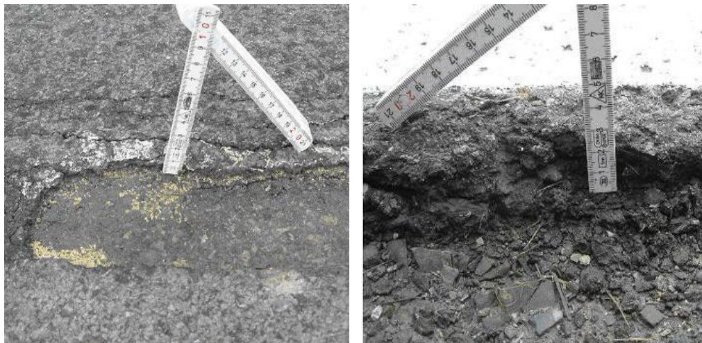
Ansicht 142: Prinzipieller Vergleich zwischen Dünnschichtbelag und Deckschicht aus Asphaltbeton. Links: Dünnschichtbelag (rund 1 cm) auf alter Asphaltbetondeckschicht aufgetragen und teilweise wieder abgelöst. Rechts: Asphaltbetondeckschicht (rund 4 cm), seitlich aufgenommen vom Fahrbahnrand.
