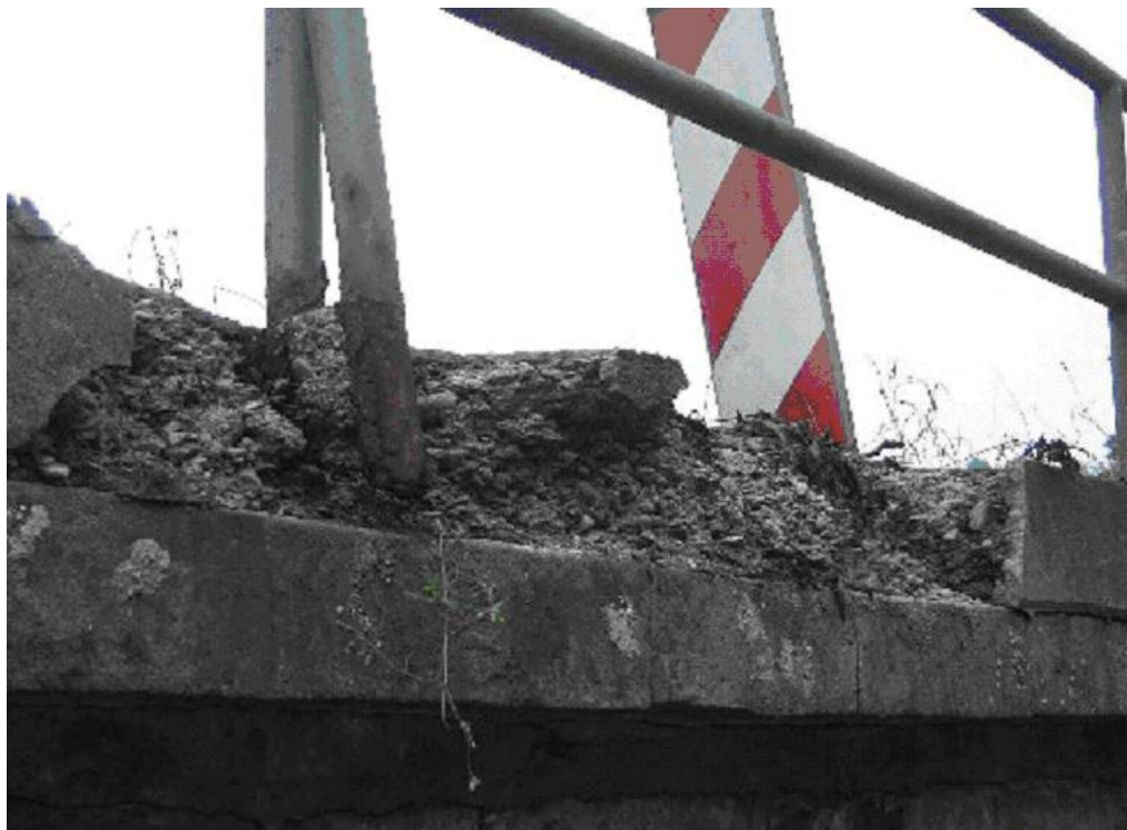
Ansicht 153: Brückenbauwerk mit ungenügendem Bauwerkszustand und Zustandsnote 3,9. Schwalm-Eder-Kreis. Unterführung Beise (Brückennummer 4923 587) im Zuge der K 29. Aufnahme aus dem Jahr 2004.
