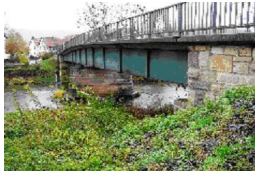
Zustandsnote 3,2 (2/ 3/ 3) Unterführung der Werra Brücken-Nr. 4725 557 im Zuge K 58 Werra-Meißner-Kreis
