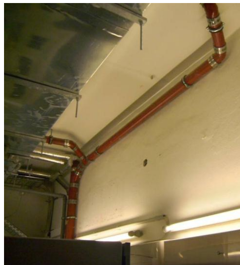
Ansicht 152: Friedberg (Hessen). Verschaltung von wasserführenden Leitungen über den Servern. Aufnahme vom 16. Juni 2011.
