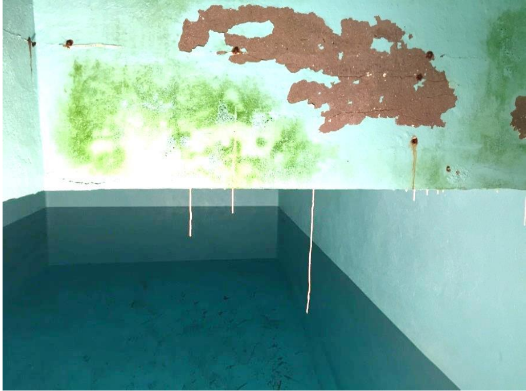
Ansicht 115: Abplatzungen und Ausblühungen in der Wasserkammer. Hochbehälter Elpenrod. Gemeinde Gemünden (Felda). Aufnahme vom 2. Juni 2015.
