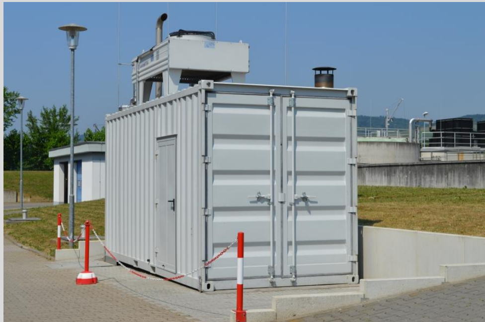
Ansicht 153: Abwasserverband Mittlerer Rheingau. BHKW der Kläranlage Geisenheim. Aufnahme im Juli 2015.
