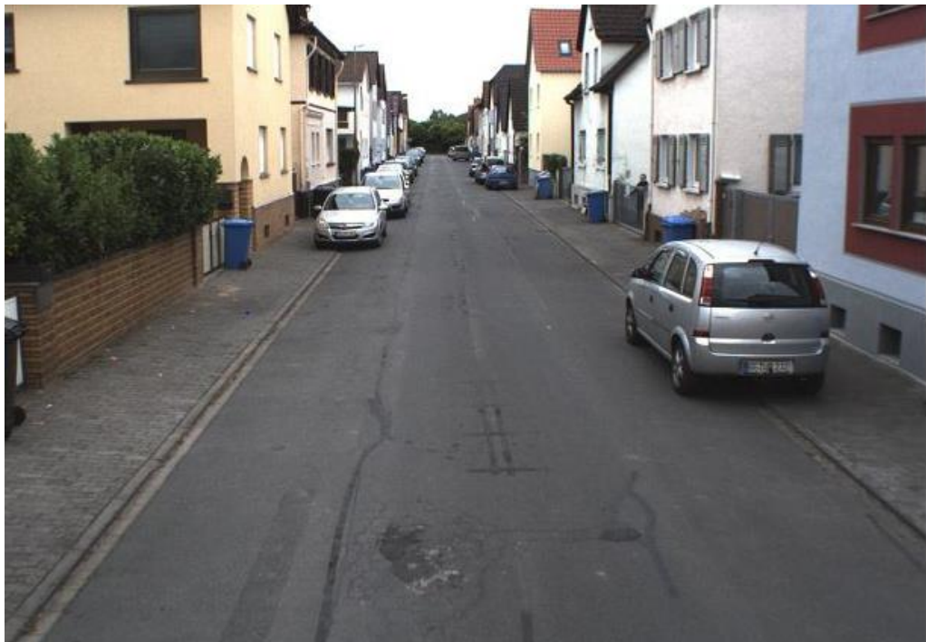
Ansicht 206: Zustandsklasse 4: Biebesheim am Rhein. Bahnhofstraße. Aufnahme vom 1. Juli 2015.
