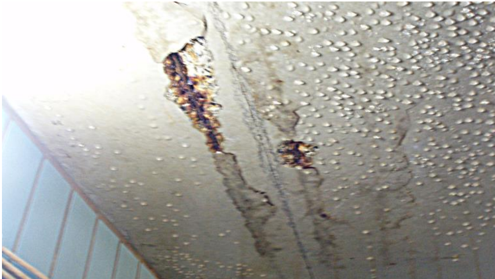
Ansicht 114: Bewehrungskorrosion sowie Schwitzwasserbildung an der Decke des Bedienungshauses. Hochbehälter Bad Zwesten Hochzone. Gemeinde Bad Zwesten. Aufnahme vom 14. Januar 2015.
