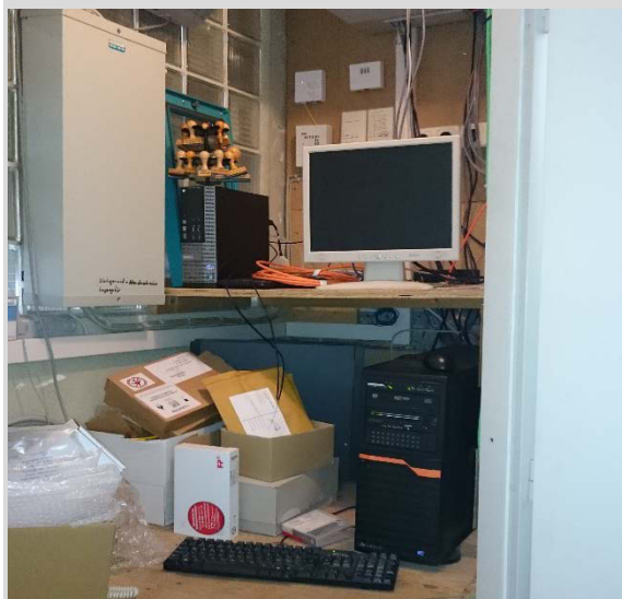
Ansicht 213: Serverraum der Gemeinde Lindenfels. Aufnahme vom 9. September 2016.
