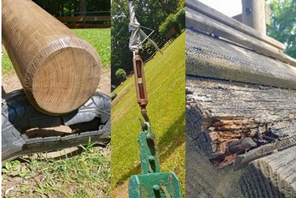
Ansicht 76: Beispiele für sicherheitsrelevante Mängel an Spielgeräten, v. l. n. r. defekter Puffer an einer Holzzippe, bodennahes einseitig offenes Spannschloss mit aufragender Spitze an einer Seilbahn, Holzverrottung am Aufstieg eines Kletterturms (Aufnahmen Mai bis Juni 2023)
