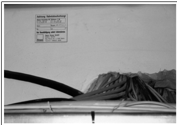
Abbildung 19-6: Polizeikommissariat Eschwege: nicht ordnungsgemäß verschlossenes Kabelschott
