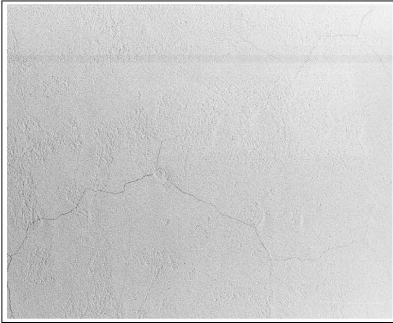
Abbildung 19-9: Typische Risse in den Außenwänden Chirurgie-Neubau
