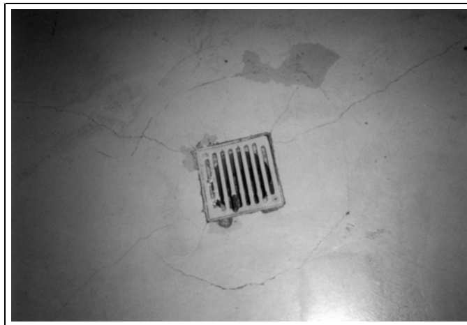
Abbildung 19-8: Informatikgebäude der FH Gießen: Risse im Estrich
