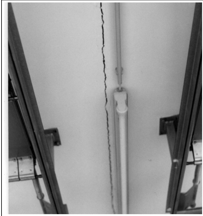
Abbildung 19-7: Polzeistation Bad Vilbel: fehlerhafte Dehnungsfuge
