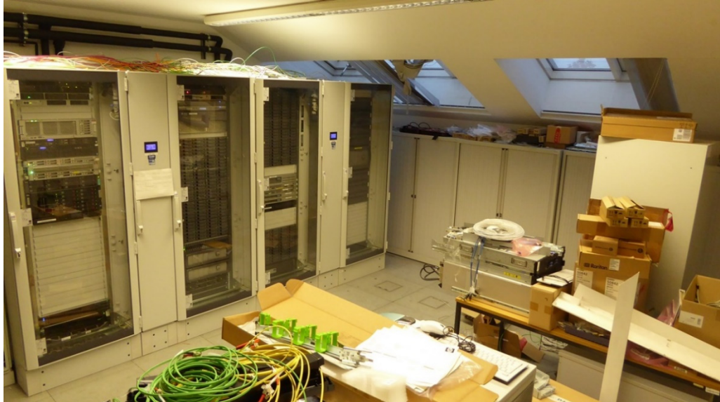
Abbildung 13-1: Haupt-Serverraum im Dachgeschoss
