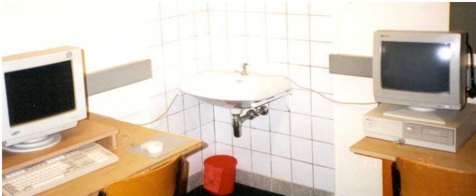
Ansicht 71: Sicherheitsrisiko Elektroleitung über Waschbecken in der Schultze-Delitzsch-Schule, Wiesbaden
