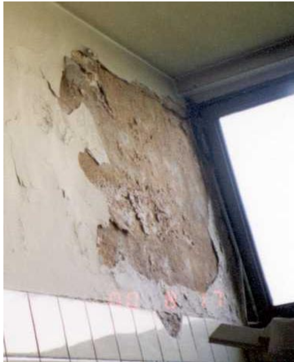
Ansicht 73: Feuchte Außenwand an der Theodor-Heuss-Schule, Offenbach am Main
