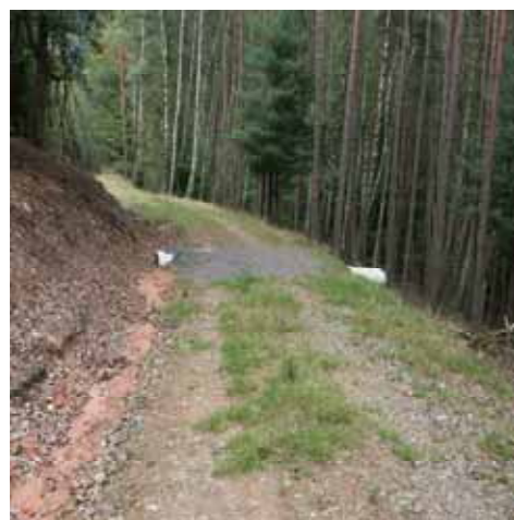
Mangelhafte Wasserführung und unzureichender Wegeaufbau (Material)
