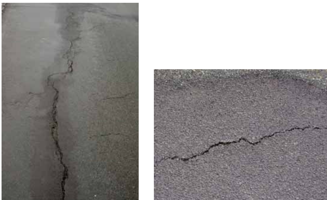
Abbildung 10-2: Zustand circa 6 Monate nach Sanierung
