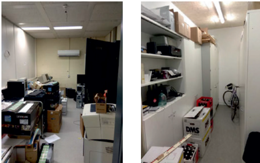
Abbildung 14–1: Unordnung im Serverraum
