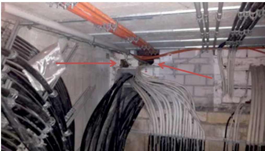
Abbildung 17–2: Fehlende Brandschottungen (Raum Hauptversorgung Strom)
