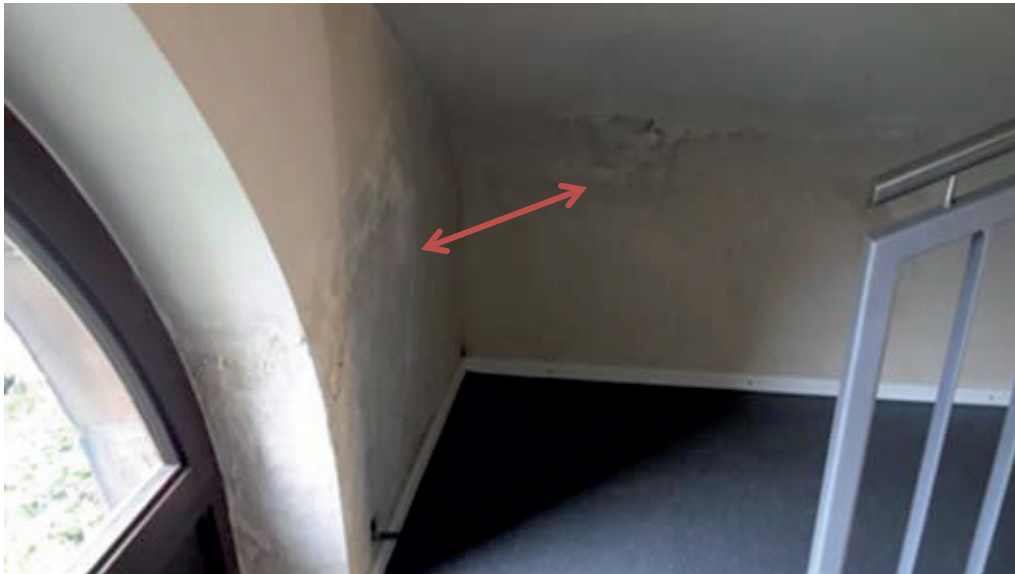
Abbildung 17-4: Wasserschaden (Erdgeschoss, Eingang Richtung Wilhelmstraße)
